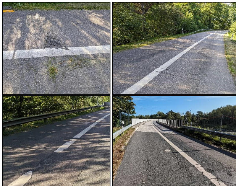
Abbildung 14 - vorhandene Straßenschäden – o.l. Schlaglöcher; o.r. Geistermarkierung; u.l. fehlende Markierung; u.r. Spurrinnen [Quelle: Eigene Aufnahmen]
